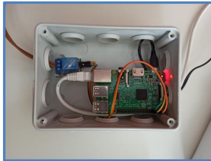
Figura 3-28: Conexión real de relé y Raspberry Pi.
