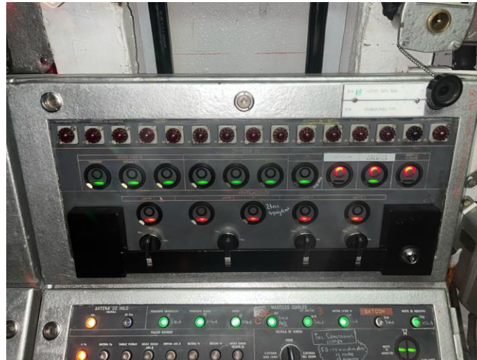
Figura 2-15 Imagen de consola controladora del sistema de lastre del submarino S-71 Galerna (Fuente propia).
