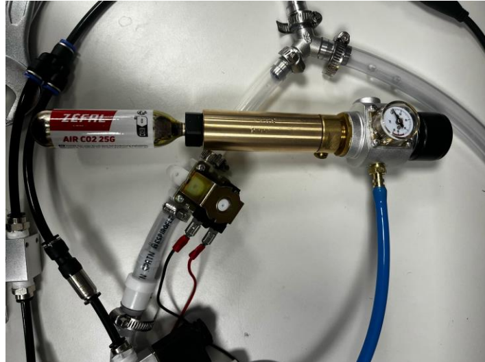
Figura 5-8 Imagen de acople de botella de aire comprimido (Fuente propia).
