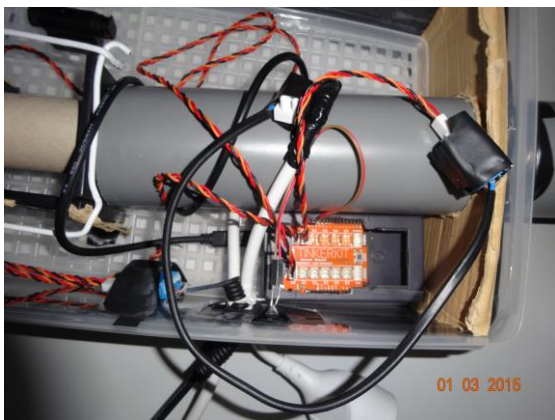
Figura 4-12 Imagen en la que entre la maraña de cables podemos diferenciar el relé (envuelto en cinta aislante negra) que conecta y desconecta la alargadera que da una vuelta sobre el tubo de PVC
