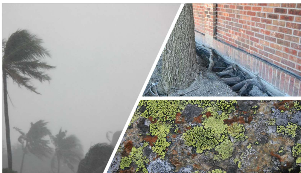
Figura 2-2 Viento, lluvia, hongos y raíces afectando a materiales pétreos
