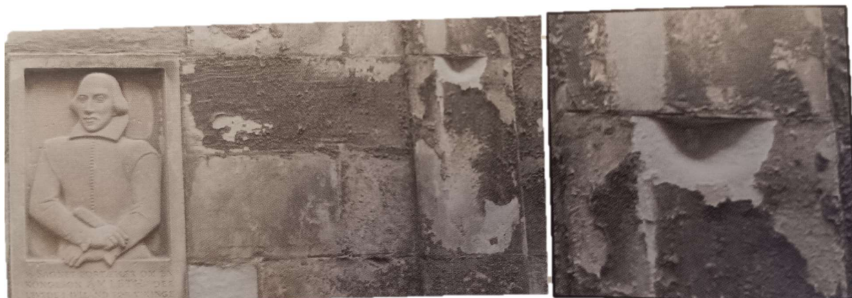
Figura 2-8 Estallido ocasionado por el calor aportado por un incendio en el Castillo de Kronborg (Dinamarca) construido en cuarzo arenita. A la derecha se muestra en detalle la zona más afectada [9]
