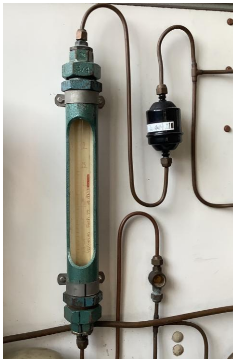
Figura 3-8 Caudalímetro y filtro deshidratador, respectivamente de izquierda a derecha de la instalación termodinámica.
