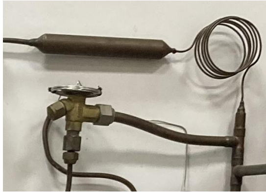
Figura 3-9 Válvula de Expansión Capilar (superior) Válvula de Expansión termostática (inferior).
