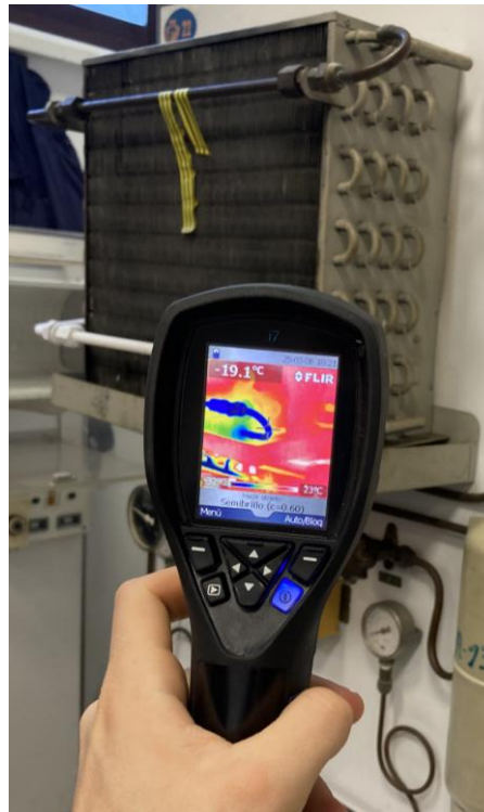
Figura 3-25 Toma de temperatura a la salida del condensador en modo de trabajo "Bomba de Calor".
