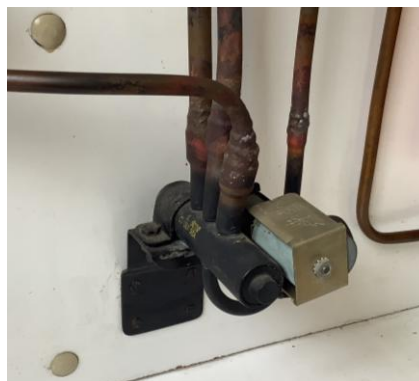
Figura 3-3 Electroválvula de tres vías de la instalación termodinámica.
