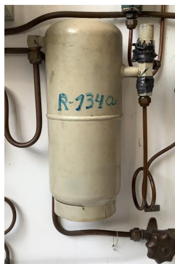
Figura 3-7 Depósito de almacenamiento de refrigerante de la instalación termodinámica.
