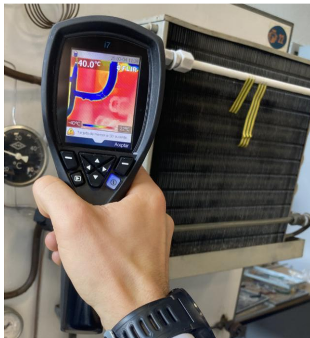
Figura 3-22 Toma de temperatura a la salida del evaporador en modo de trabajo "Máquina de Refrigeración".
