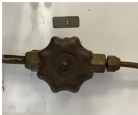
Figura 3-12 Ejemplo de una de las válvulas (la número 1) de la instalación.
