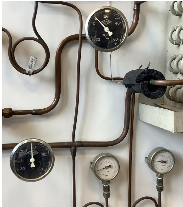
Figura 3-11 Ejemplo de termómetros (negro) y manómetros (blancos) en la instalación termodinámica.
