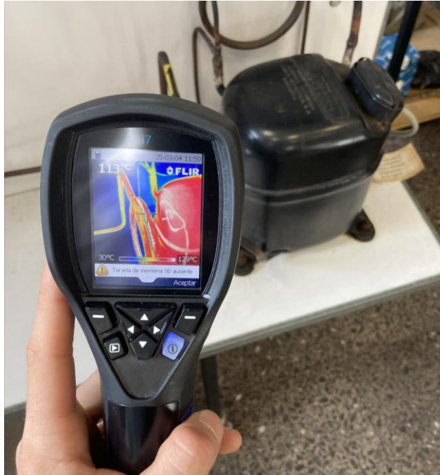
Figura 3-21 Toma de temperatura del compresor. Exceso de temperatura. En este momento es recomendable apagar la instalación.
