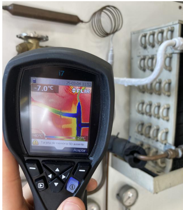
Figura 3-23 Toma de temperatura entre la salida de la válvula de expansión capilar, y la entrada al evaporador en el modo de trabajo "Máquina de Refrigeración"
