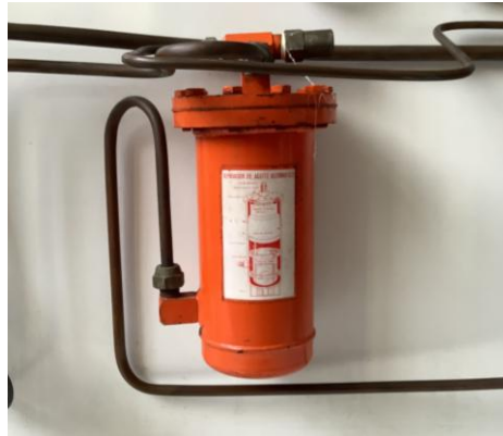
Figura 3-4 Filtro de aceite de la instalación termodinámica.
