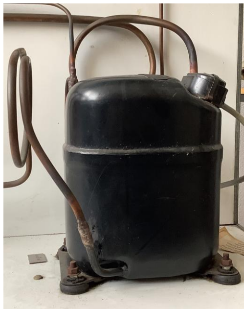
Figura 3-1 Compresor de la instalación termodinámica.
