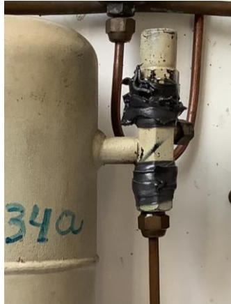
Figura 3-15 Válvula de servicio del tanque de almacenamiento de refrigerante, con el arreglo a base de cinta aislante.
