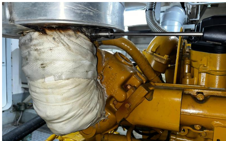
Figura 3-12 Orificio en el codo de gases de escape (4N-4967) con la sonda del equipo introducida (fuente propia).
