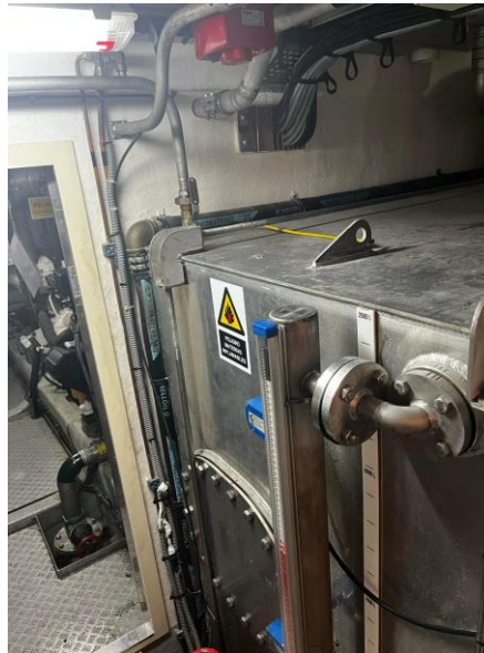
Figura 3-5 Tanque de combustible de babor GM Chereguini (fuente propia).
